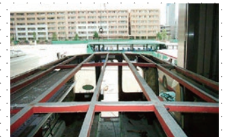
骨組みだけが残る屋根部分
