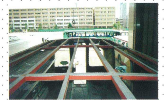
骨組みだけが残る屋根部分
