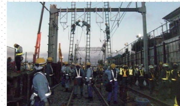
【竣工】2012年8月 【施工】電設事業本部 電力工事業部・信号工事業部
