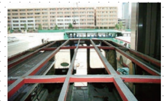
骨組みだけが残る屋根部分
